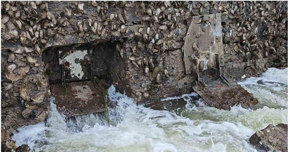
Sistema de drenaje invadido por las ostras
